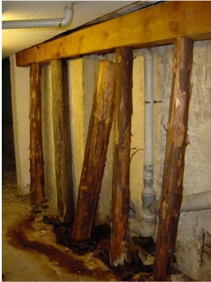
Einsturzgefahr im Keller
