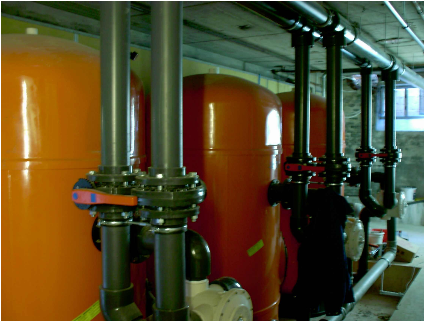
Neue Schwimmbad- technik im Keller
